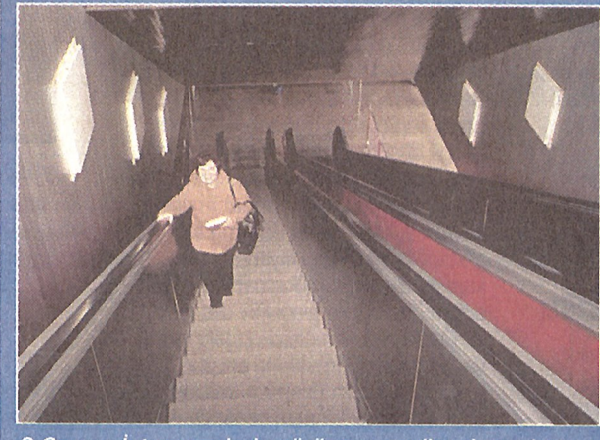
S.Çeşme İstasyonu'nda yürüyen merdivenler çalışmıyor
